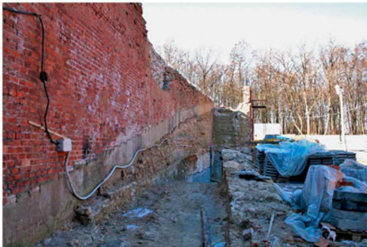
Ryc. 1. Fort nr 2 Kościuszko. Kurtyna I-V ze zniszczoną rampą, fot. H. Rojkowska-Tasak.
