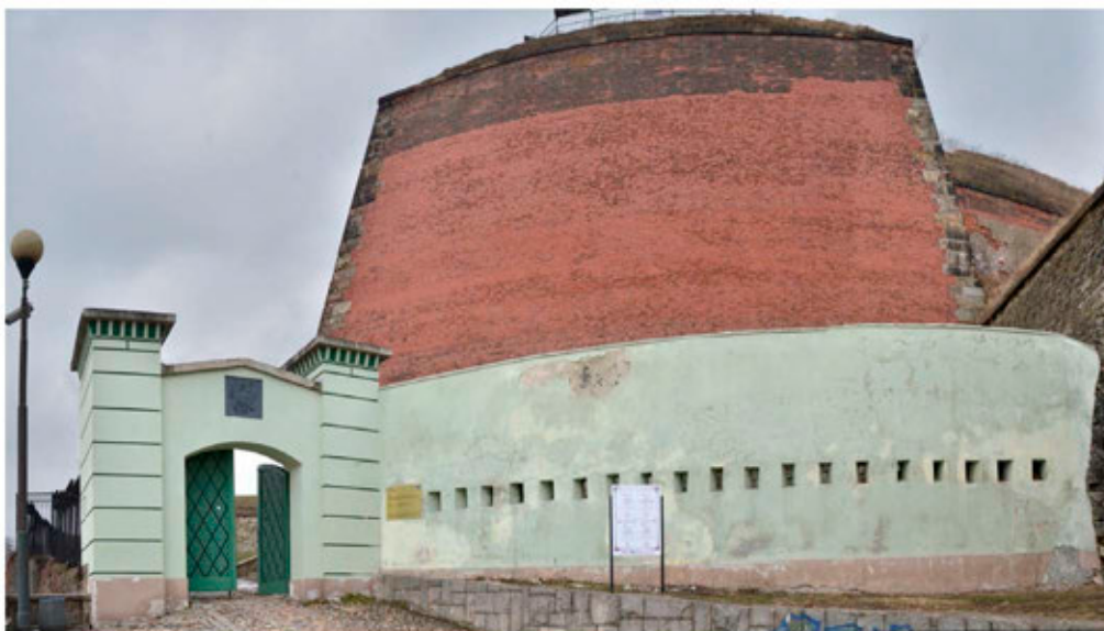
Fot. 1. Kłodzko, Twierdza Główna, Brama Miejska (pol. XIX w.) po renowacji w 2010 r. z zachowaną oryginalną stolarką. Brak badań historycznych, archeologicznych, architektonicznych, mykologicznych i profesjonalnych badań stratygraficznych oraz błędy w wykonawstwie dały odpowiednio widoczne efekty. Fot. G. Basiński 2013.
