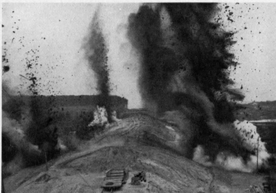
Abb. 44. Moorsprengung beim Bau einer Reichsautobahn. Ein über dem Moor aufgeführter Sandwall von 24 m Höhe und 400 m Länge wird durch die Sprengung des darunter liegenden Moorbodens* in das Moor versenkt, so daß er eine feste Unterlage für den Straßenbau bildet. (Aufnahme: Scherl)
