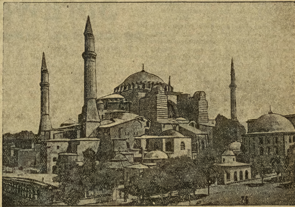
Sławnej katedrze św. Zofji, przerobionej przez Turków na meczet, grozi zawalenie. Pod jednym z środkowych filarów wykryto źródło, które podmyło fundamenty. Dla uratowania sławnej katedry będzie trzeba przeprowadzić bardzo kosztowne roboty.
