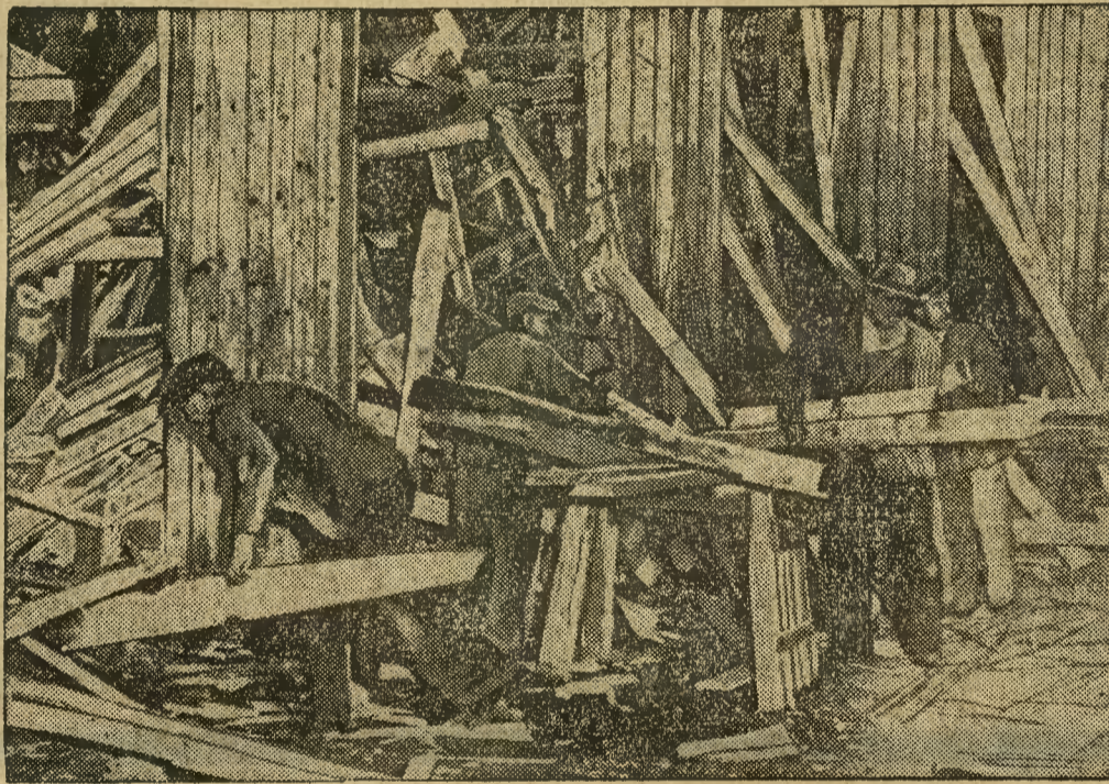
W Pradze budują zbyt pośpiesznie nowy gmach giełdy. Szkielet żelbetonowy wyciągnięto już do wysokości 25 metrów, gdy naraz runęła posowa głównej sali, zabijając 20 robotników.
