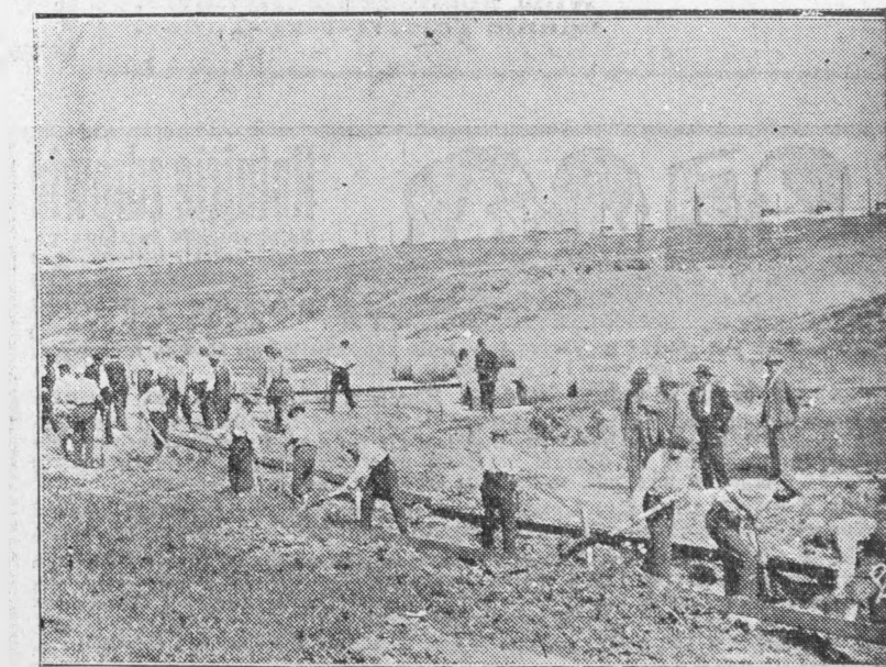
Od kilkunastu dni wre gorączkowa praca przy budowie nowej linii tramwajowej, która ma w niedługim czasie połączyć osiedle pocztowców w Babcach z centrum miasta Warszawy.
