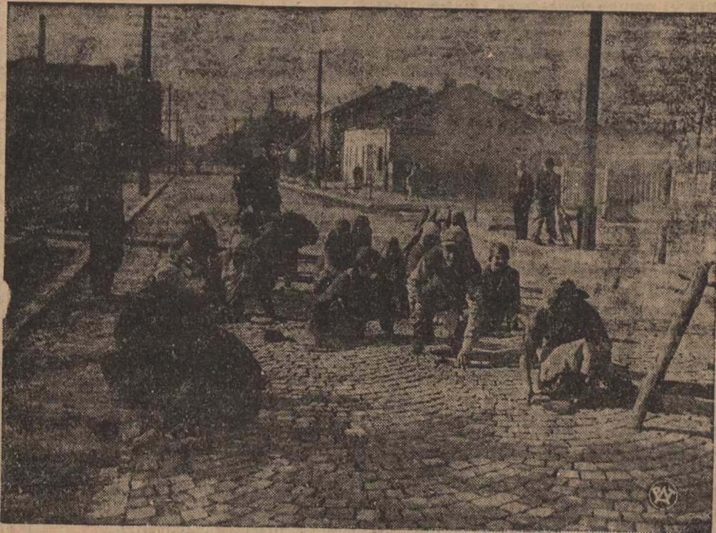
Budowa nawierzchni z kostki granitowej szosy budowanej w Krzeszowicach z zasiłku Funduszu Pracy
