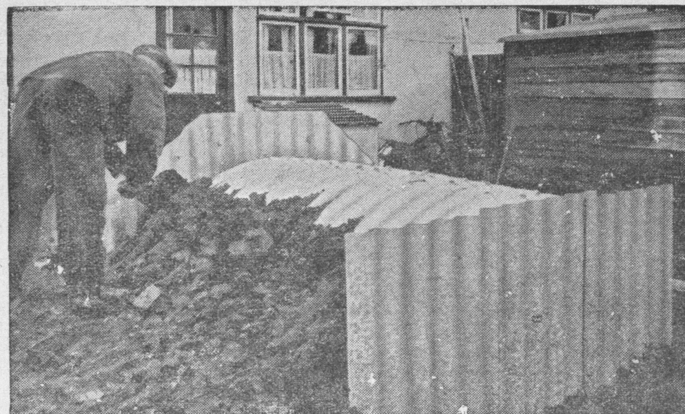
W Anglii rozpoczęto budowę małych składanych schronów przeciwgazowych. Oto jeden ze schronów w ogródku podczas przykrywania ziemią.
