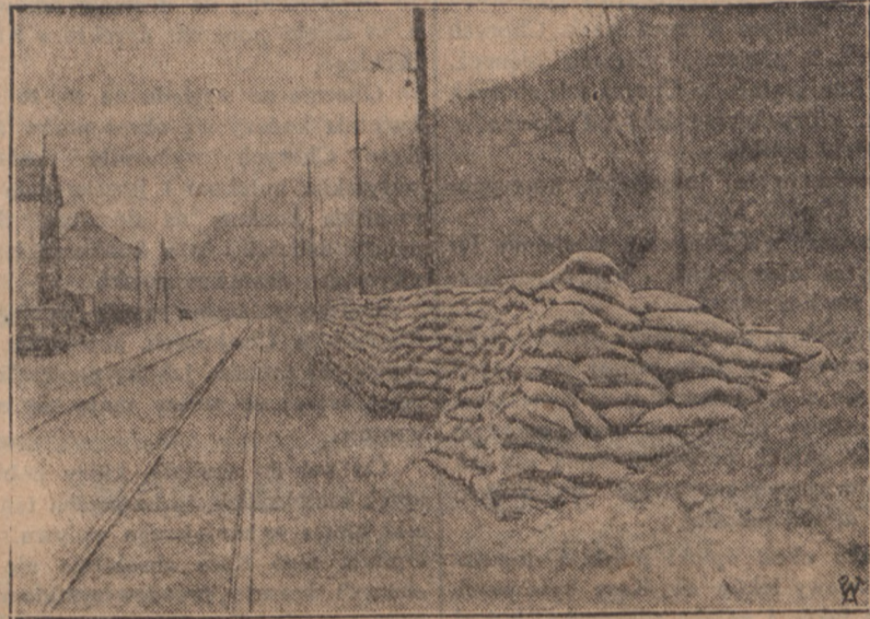
W pobliżu miejscowości Chatelet w Belgii zaczęło się niedawno obsuwać dość wysokie wzniesienie, grożące zasypaniem drogi wiodącej do tej miejscowości. Na zdjęciu naszym widzimy zapory, mające na celu zapobiec zasypaniudrogi przez obsuwające się zwaly ziemi.
