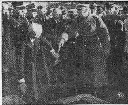
W Antoninie, miejscowości w Centr. Okr. Przem., odbyło się poświęcenie kamienia węgielnego i wmurowanie aktu erekcyjnego pod budowę szkoły im. gen. broni Kazimierza Sosnkowskiego. Generał Sosnkowski kładzie pierwszą cegłę w fundamenty gmachu.
