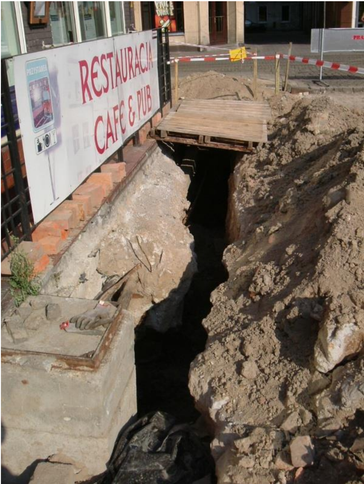
Ryc. 9. Relikty pach sklepień. Pierzeja północno-wschodnia Rynku. Stan w 2010 r. fot. M. Szajerka.
