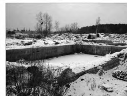
Stan obecny – obcięty od góry stalowy zbiornik cylindryczny na ceglany fundament jest wypełniony szlamem kreozotowym i stale wycieka z niego płynna frakcja oleju impregnacyjnego
