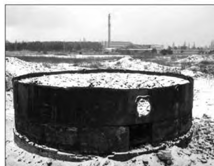
Widok odsłoniętego „basenu”, czyli dawnego podziemnego, murowanego zbiornika, do którego trafil kreozot w razie tzw. zrzutu awaryjnego w czasach, gdy działała nasycalnia
