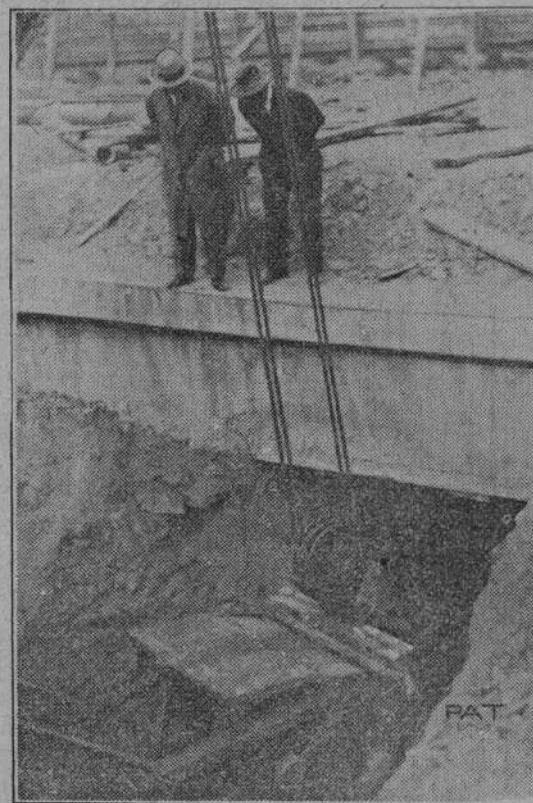
Po długoletnich wysiłkach nastąpiło spotkanie pod ziemią dwu grup robotników, zatrudnionych przy kopaniu tunelu pod Al. Jerozolimską.
