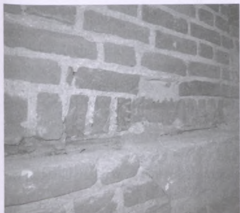
Gniazda belek stropowych i rolki wzmacniająca mur przed rekonstrukcją (fot. M. Oleksy).
