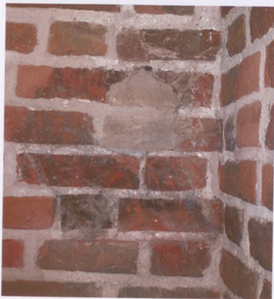
Fot. 10. Kanał grzewczy zaślepiony zaprawą szamotową.
