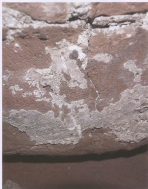
Fot. 13. Pobiąta wapienna zachowana na podniebieniu sklepienia wnętrza okiennej (fot. M. Oleksy).
