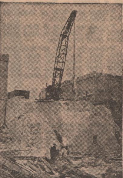
Robótka mostu pod Grudziądzem postępuje powoli naprzód. Na zdjęciu fragment prac robótczych na przyczółku mostowym. Potężny dźwig składa żelazne części mostu na wagonach, które zawiozą je do hali ślaskich
