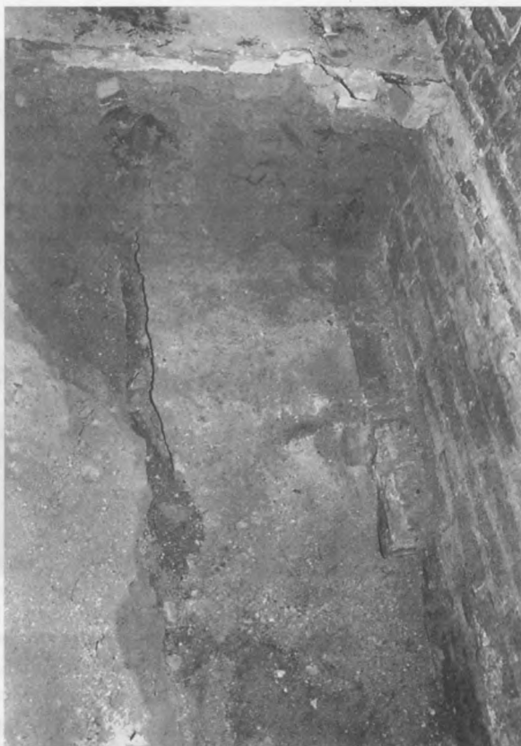
Fot. 15. Sondaż 7. W dnie warstwa za- prawy wapiennej z negatywem belki od rusztowania (?) przy ścianie wschodniej obecnego prezbiter- ium. Fot. P. Wit- kowski
