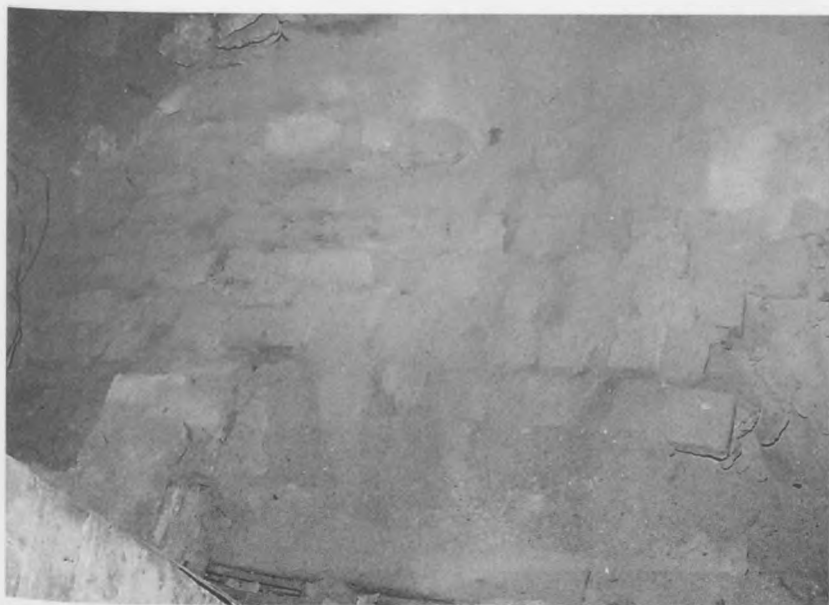
Fot. 3. Fragment posadzki ceglanej – pierwotny poziom użytkowy obecnego prezbiterium. Fot. M. Furmaniuk
