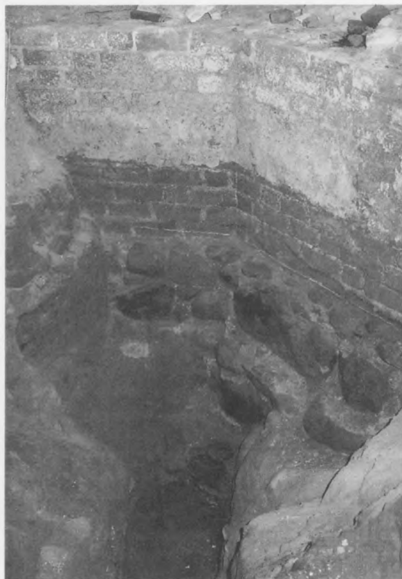
Fot. 14. Lico wewnętrzne poligonalnego zakończenia pierwszego kościoła w wykopie II. Powyżej kamiennego fundamentu widoczne na ceglach ślady podłogi drewnianej, powyżej zaś lico zachłapane zaprawą w trakcie budowy obecnego prezbiterium.
