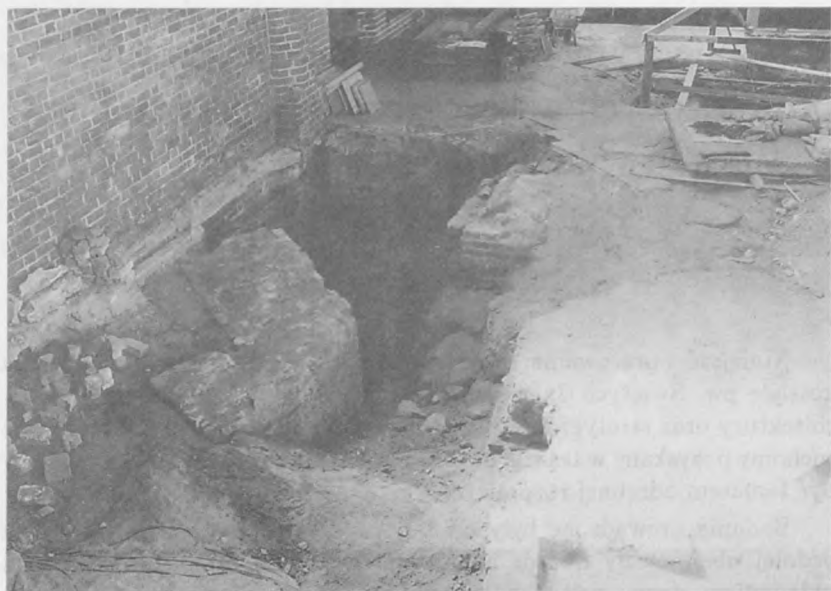
Fot. 1. Widok od strony wschodniej na wykopy I i III (w głębi). Fot. P. Witkowski
