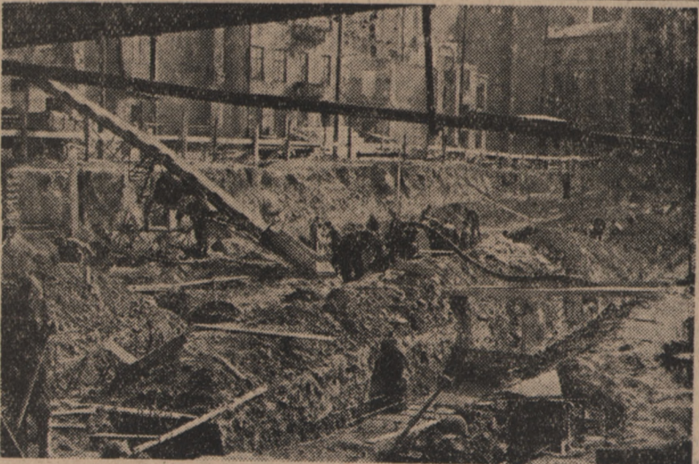
Na obu odcinkach budowy Marszałkowskiej Dzielnicy Mieszaniowej roboty nabierają coraz szybszego tempa. W dniu 29 września 1950 r. rozpoczęło się betonowanie ław fundamentowych pod trzeci kolejny budynek nowej dzielnicy śródmieścia. Na zdjęciu: Fragment prac na terenie MDM. (Foto — Film Polski)
