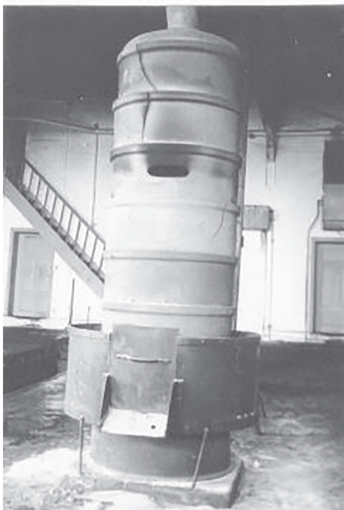
Ryc. 74. Piec centralnego ogrzewania hali.
