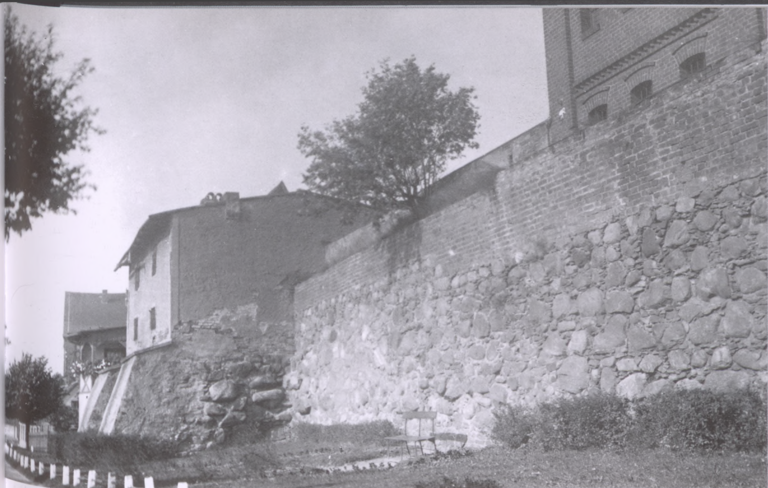
Południowa, tu jeszcze oryginalna, linia murów miejskich. Pod Basztą Kurza Stopa widać wybrzuszące się głazy fundamentów. Ostatecznie głazy runęły 7 czerwca 2017 r.
