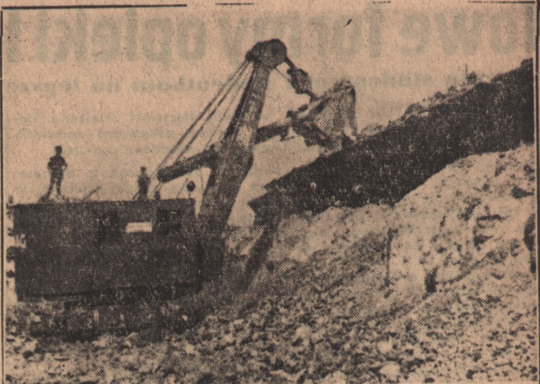
Linie komunikacyjne coraz gęstszą siecią pokrywają nasz kraj. Na zdjęciu: Kopalnia pracująca przy wykopach pod budowaną linią kolejową Kielce — Busko. Foto — CAF
