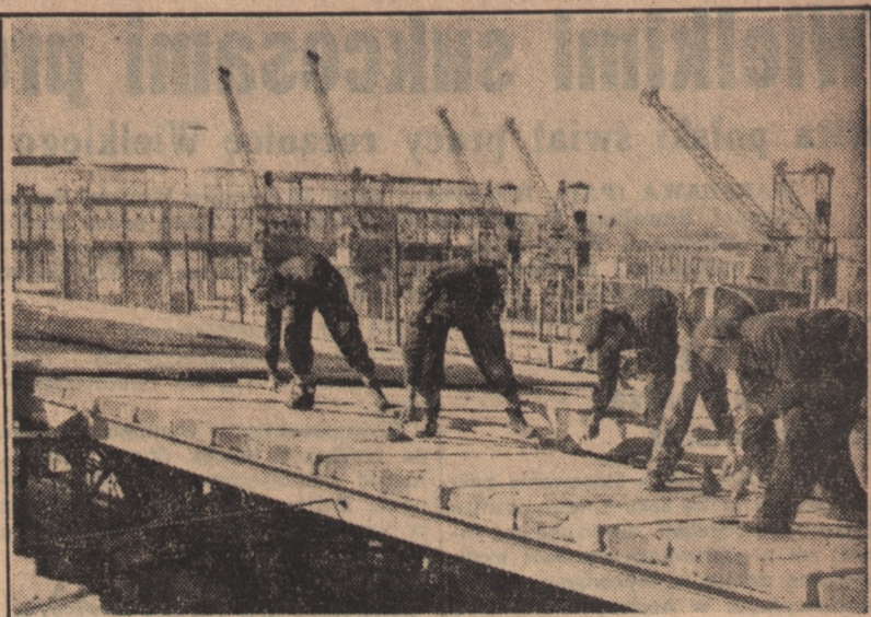
Zaloga budowy kombinatu w Nowej Hucie w odpowiedzi na apel SFO zobowiązała się oddać do użytku całkowicie wykończony jeden z obiektów huty do dnia 15. 11 1951 r. drugi zaś w tym samym terminie oddać w stanie surowym. Na zdjęciu Młodzieżowa brygada murarzy ZMP-owców Mariana Grzędy w składzie: Stanisław Łaska, Maksymilian Groszowski, Marian Kanik, Kazimierz Więsieć i Jan Czuchra — układa i zalaminuje płyty dachowe halę kuźni, wyrabiając 200 proc. planu.
