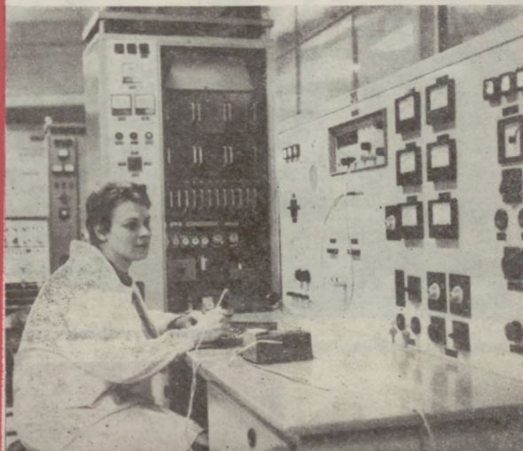
Stanowisko do regulacji zespołów tyrystorowych w PZAE EMA-APATOR
