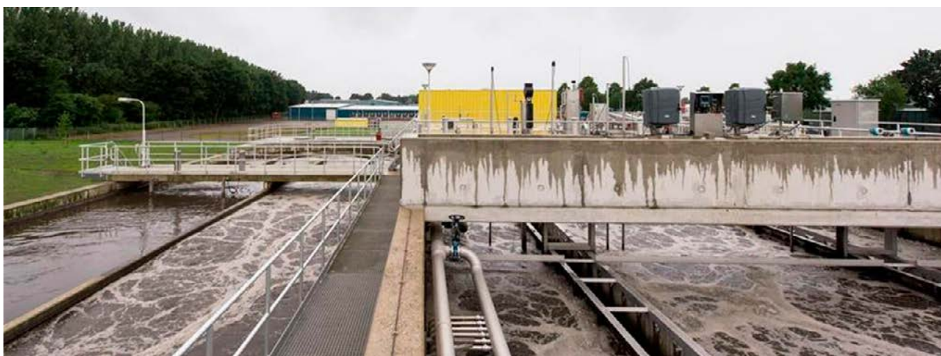
Rysunek 5-9. Oczyszczalnia ścieków w miejscowości Vroomshoop (Holandia). System hybrydowy klasycznego osadu czynnego (po lewej) oraz osadu granulowanego (po prawej) [royalhaskoningdhv.com]
