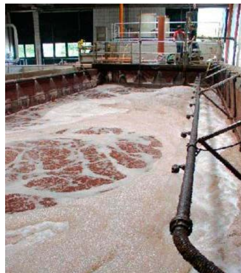
Rysunek 7-15. Reaktor do deamonifikacji w oczyszczalni ścieków w miejscowości Strass im Zillertal (Austria) [Wett i in. 2007]
