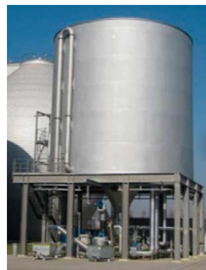
Rysunek 4-11. Reaktor do odzysku fosforu w oczyszczalni ścieków w Waßmannsdorf (Niemcy) [Nieminen 2010]
