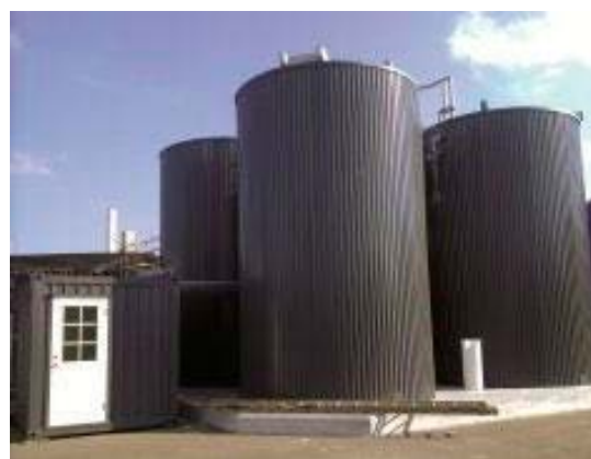
Rysunek 7-17. Instalacja do deamonifikacji w oczyszczalni ścieków w miejscowości Malmö (Szwecja) [veoliawatertechnologies.pl]
