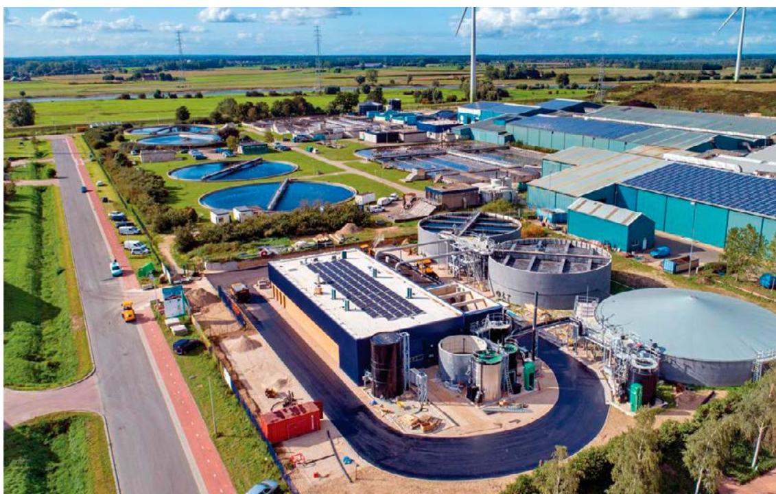
Rysunek 8-7. Widok na oczyszczalnię ścieków w Zutphen (Holandia) [Lavender i in. 2021]
