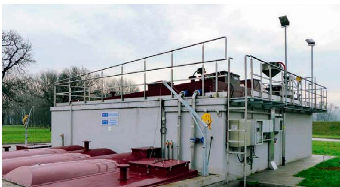
Rysunek 7-16. Instalacja do deamonifikacji w krakowskiej oczyszczalni ścieków „Kujawy” (Polska) [Biedrzycka 2016]
