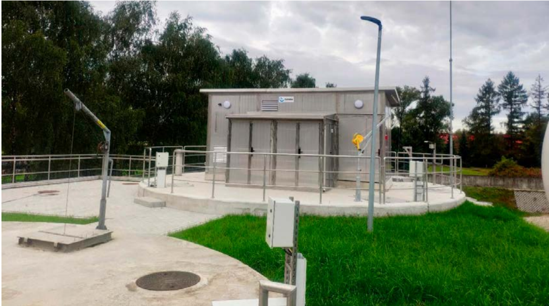
Rysunek 7-18. Instalacja do deamonifikacji w oczyszczalni ścieków „Komorowice” w Bielsku-Białej (Polska) [materiały pozyskane od Aqua S.A.]
