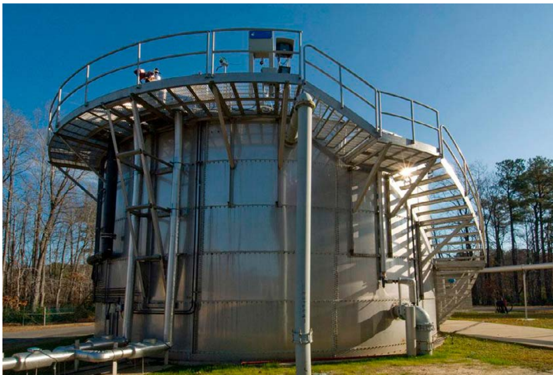
Rysunek 7-14. Reaktor do deamonifikacji na oczyszczalni ścieków York River w stanie Virginia (USA) [aaees.org]
