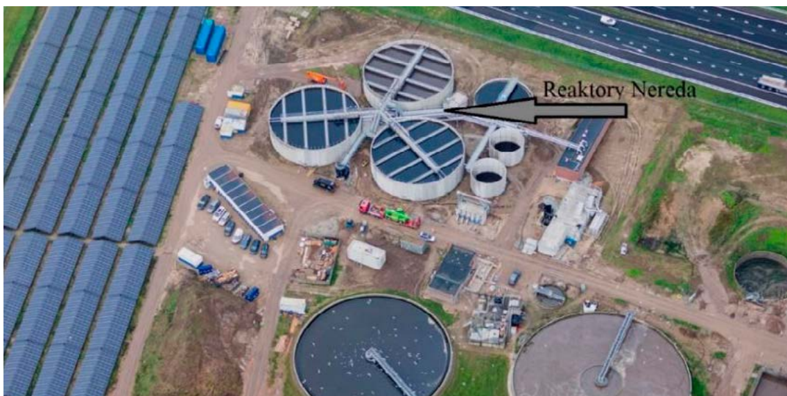
Rysunek 5-8. Widok na oczyszczalnię ścieków w Dodewaard (Holandia) [royalhaskoningdhv.com]
