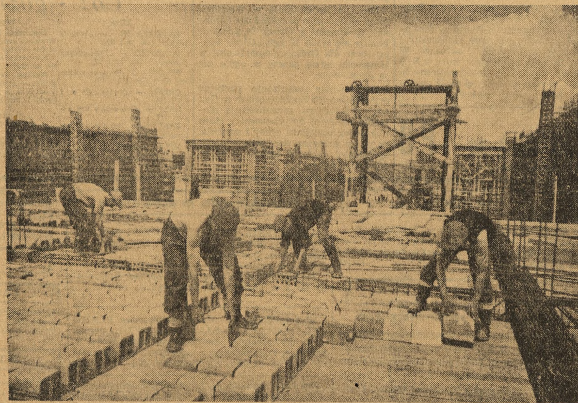
Prace przy budowie Marszałkowskiej Dzielnicy Mieszkaniowej, która z godziny zmienia swój wygląd, postępują naprzód w prawdziwie warszawskim tempie.
