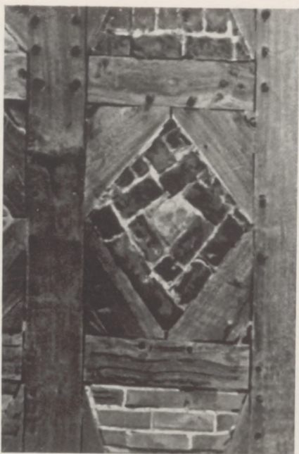
Wexen, Kr. Harburg. In die aus Holz gebildete Raute ist in Backsteinen sichtlich die Schleife gesetzt worden, so daß die Sinnbildabsicht klar wird. 18. Jahrhundert.
