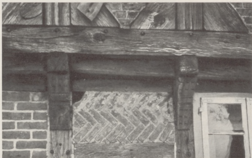
Oldendorf, Kr. Lüneburg. Es liegt die Vermutung nahe, daß das Backsteinmuster ebenfalls ursprünglich von Sinnbildbedeutung war. Es findet sich an älteren Bauten häufiger als an späteren. Um 1650.
