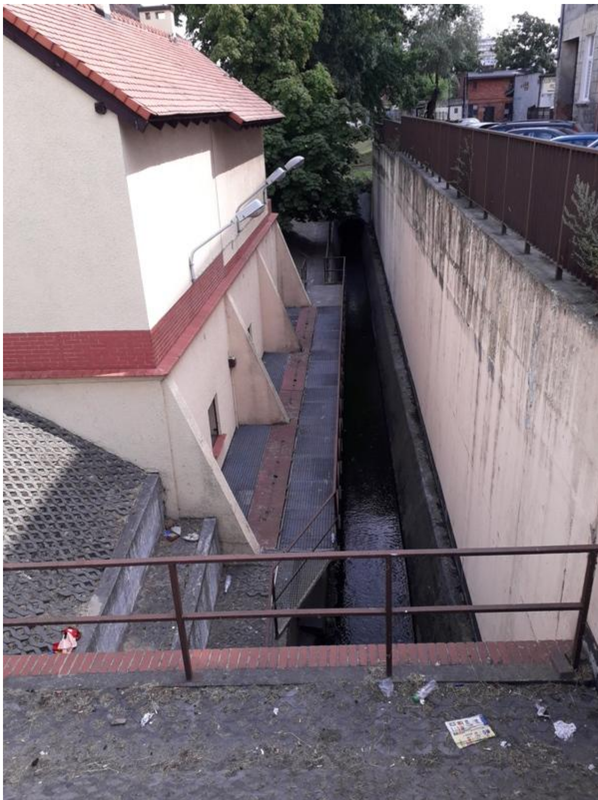
Przepompownia na Rowie Hermanna.
