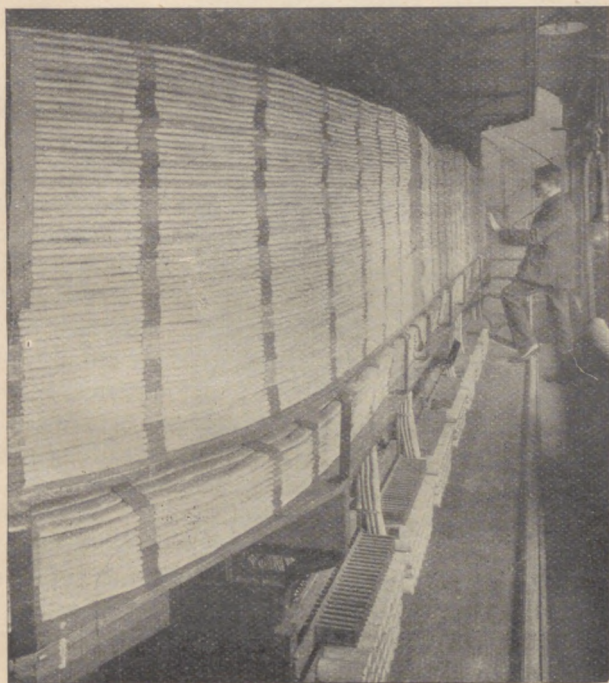
Die Kabel mit den Telephondrähnen auf einem Fernsprechamt.
