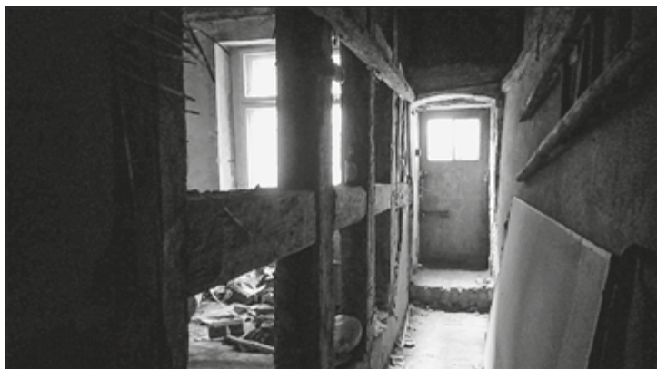
Il. 8. Grudziądz. Zachowana ściana działowa budynku przy ul. Długiej 16 postawiona w konstrukcji szkieletowej (stan: 28.02.2019, w trakcie prac remontowych)
