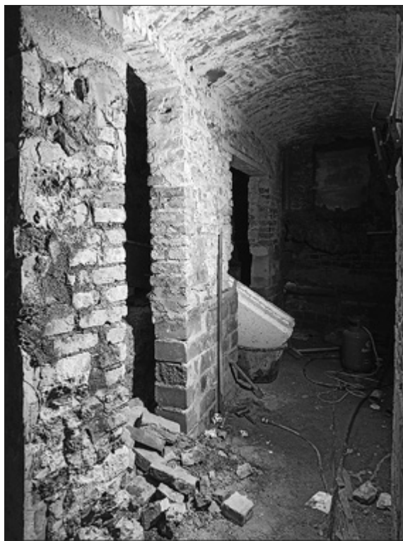
Il. 16. Budynek przy ul. Spichrzowej 57 w trakcie prac remontowych. Fot. I. Fijałkowska
