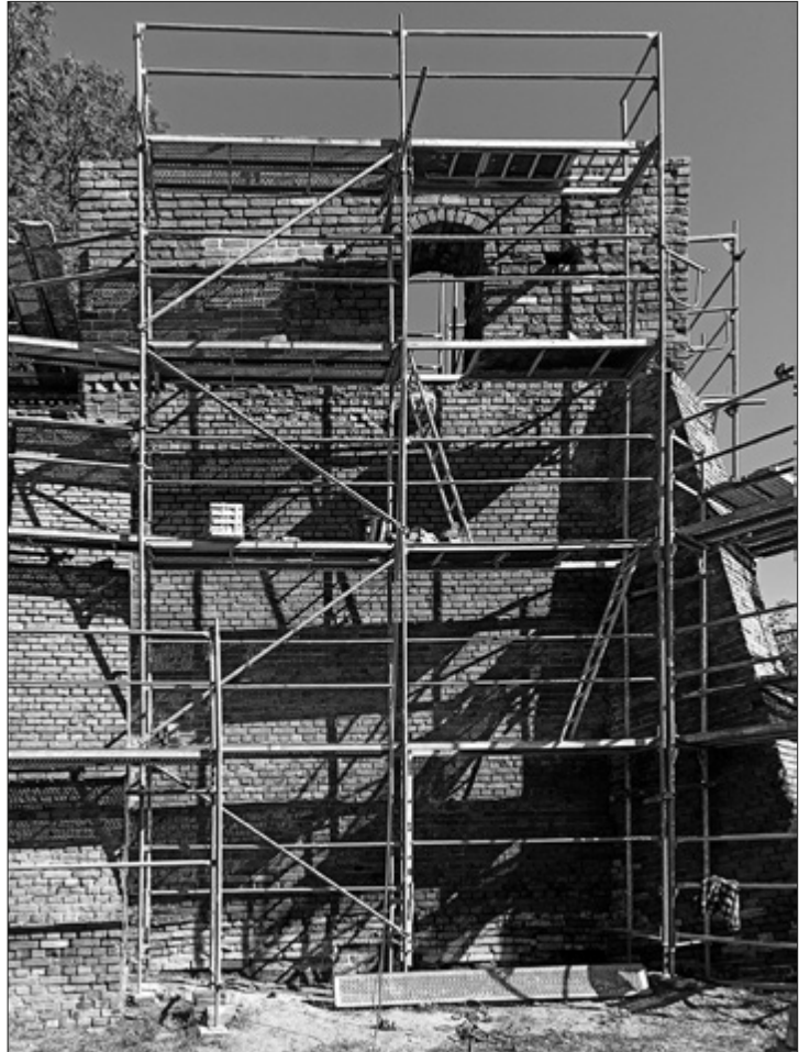
Il. 3. Mury miejskie w trakcie prac konserwatorskich (stan na 07.09.2022). Fot. I. Fijałkowska
