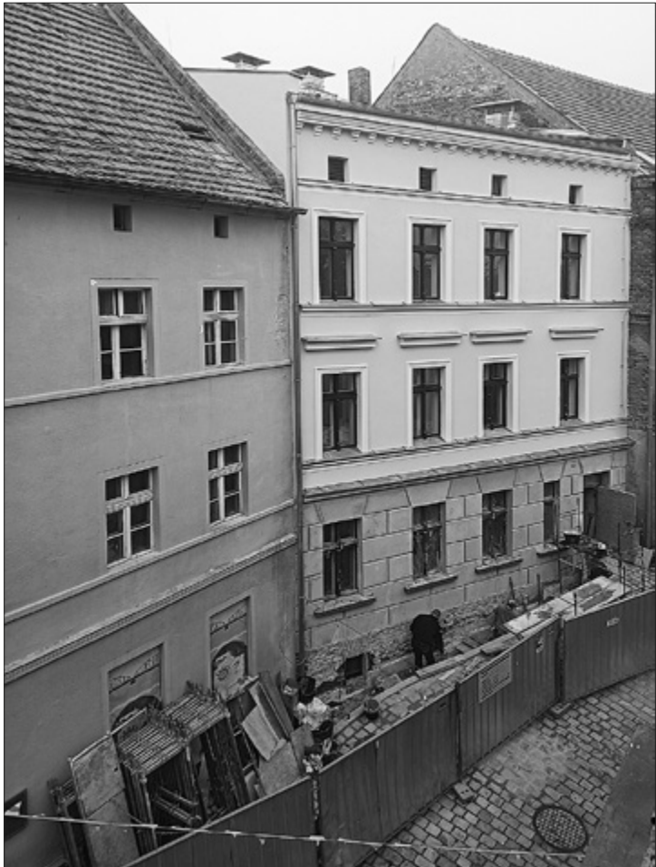
Il. 8. Elewacja budynku przy ul. Spichrzowej 57 w trakcie prac konserwatorskich (stan na 27.10.2022). Fot. I. Fijałkowska
