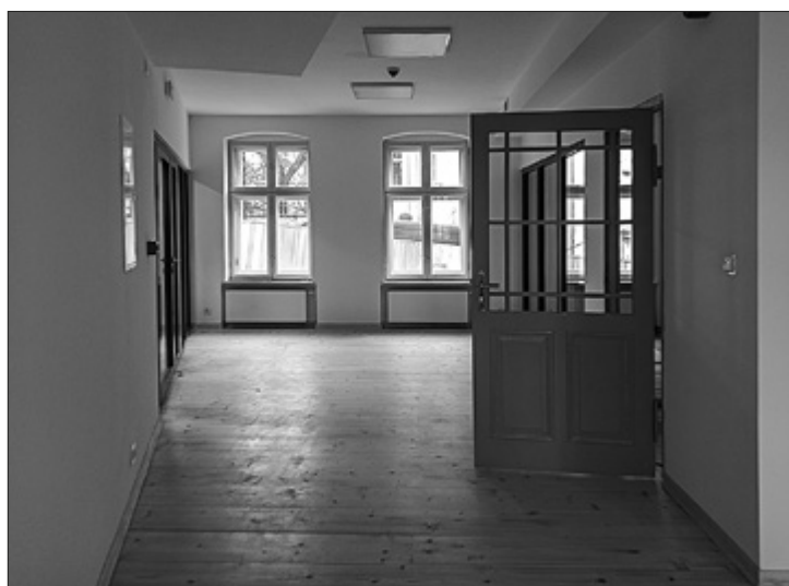
Il. 10. Wnętrze budynku przy ul. Spichrzowej 57 w trakcie prac konserwatorskich (stan na 12.01.2023). Fot. I. Fijałkowska
