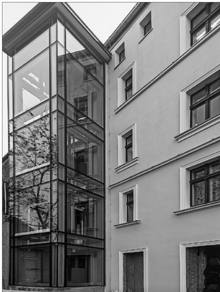
Il. 9. Elewacja budynku przy ul. Spichrzowej 57 w trakcie prac konserwatorskich (stan na 27.10.2022). Fot. I. Fijałkowska
