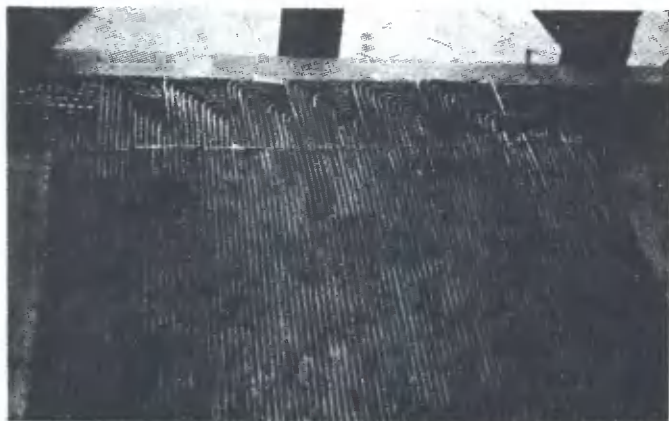
Rys.3.9. Kable ułożone w kanale i na płaszczyźnie obudowy cewki
