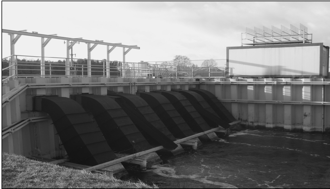
Fot 3. Nowy przekop i nowy jaz wraz z turbinami – oddany w 2008 roku.- widok od strony zrzutu. (zdjęcia autorów)
