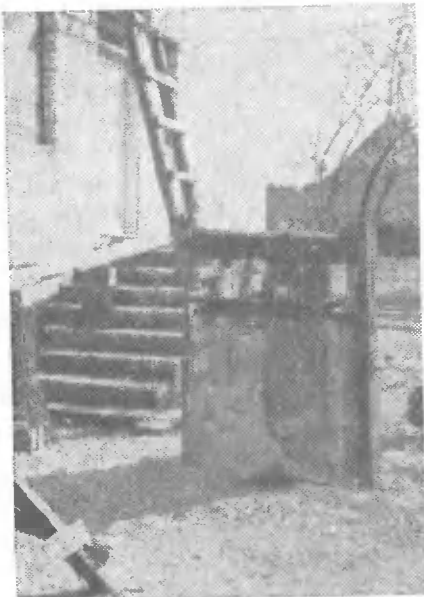
Fot.4. Studnia nr 22 nieszczelna, zniszczona cembrowina, brak obudowy zabezpieczającej przed przedostaniem się zanieczyszczeń z zewnątrz
