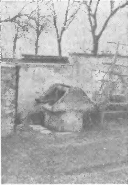
Fot.1. Studnia nr 16, nieszczelna cew - browina, widoczne plamy zacieko- we i prosty
