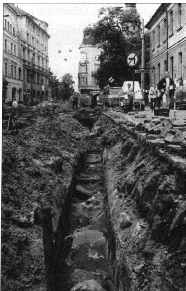
Ryc. 2. Wnętrze kanału burzowego po zerwaniu stropu. Fot. T. Zajączkowska.
